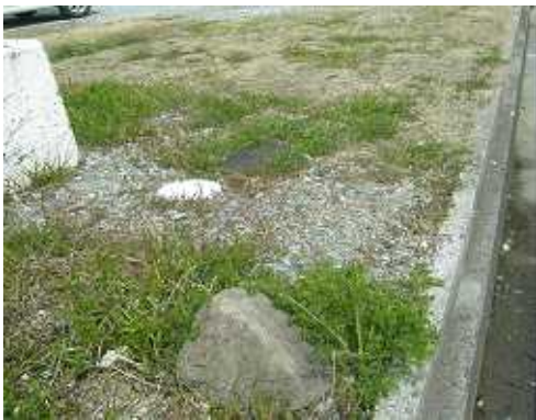
121㎡ 駐車場に使い、汚水マス・水道メータ設置にもかかわらず、代金徴収ナシ
