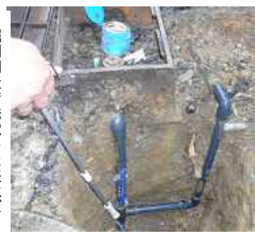
掘削調査で発覚した盗水バイパス管。平成23年12月8日
